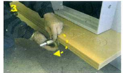
3 Verspannung des Gerüstbrettes (Diele) oder der Schalung direkt gegen die Bodenplattenstirne.
